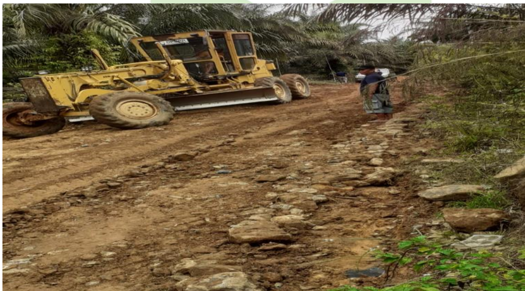
Gambar 7. Dana CSR PTPN IV untuk Perbaikan Jalan yang Rusak
