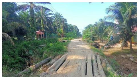
Gambar 1.12 Kondisi Jembatan kayu yang memerlukan bantuan program CSR
