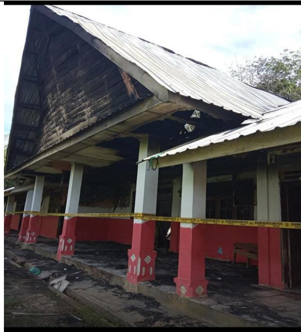
Foto SDN 099 Proyek Batang Gadis setelah kebakaran pada tahun 2020
